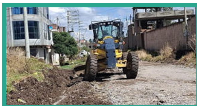
➔ Perfilado y compactado de vía no pavimentada en la calle Rosita Salas
