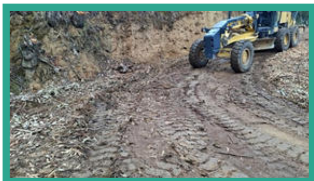
➔ Perfilado y compactado de vía no pavimentada en anexo de Saños Chico
